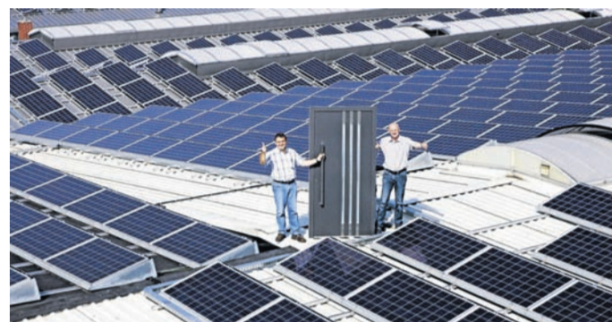
HDE hat seine Energiewende 2012 realisiert: Franz-Josef Stotter (l.) und Herbert Sandscheper auf den mit Solarmodulen ausgestatteten Hallendächern. Foto: HDE
